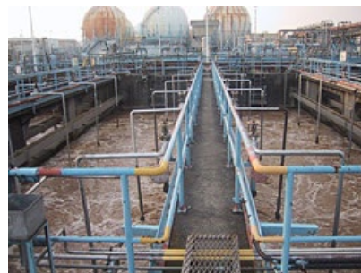
活性汚泥処理装置
