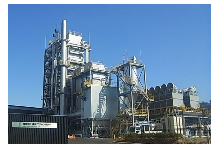
大野発電所全景
