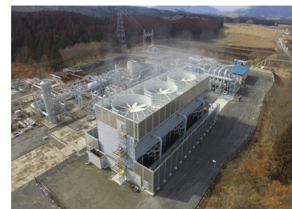
滝上バイナリー発電所の冷却塔から放出される蒸気
