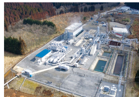
滝上バイナリー発電所の全景
