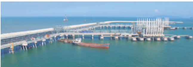
ニソン製油所・石油化学コンプレックスの沿岸エリアの建設
