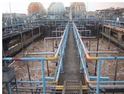
活性汚泥処理装置
