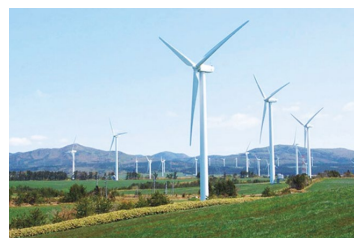
六ヶ所村二又風力発電所 写真提供：日本風力開発（株）
