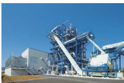
土佐グリーンパワー(株)土佐発電所
