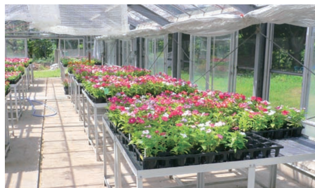
千葉県袖ケ浦市内の温室設備
