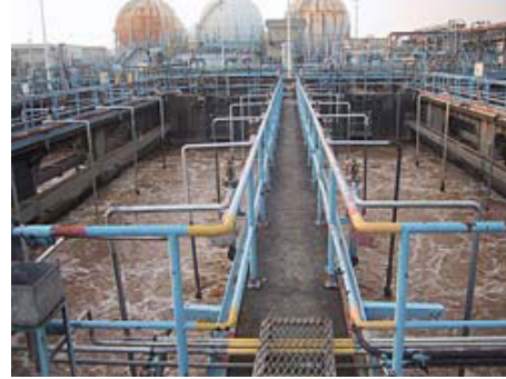
活性汚泥処理装置
