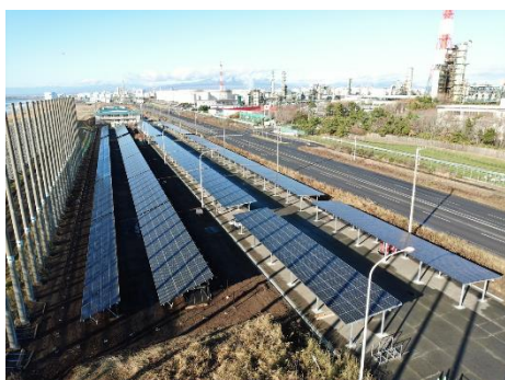
導入した太陽光発電設備
