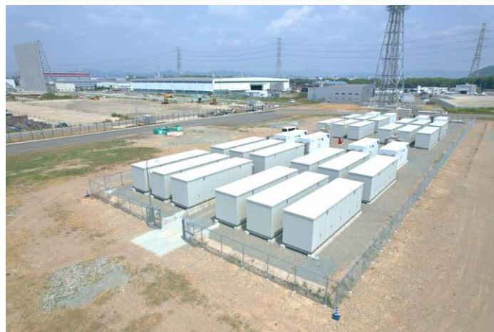
（姫路蓄電所／2025 年 8 月撮影）
