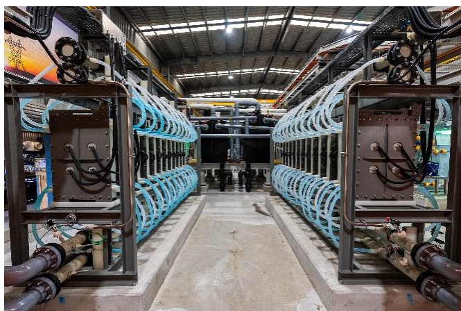
バナジウム電解液の製造の様子（Vecco 社製造設備）
