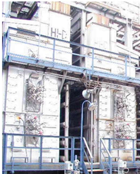
実証実験を行ったナフサ分解炉
