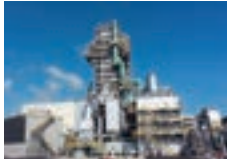
京浜バイオマス発電所
