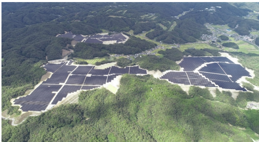
SF 赤磐太陽光発電所全景
