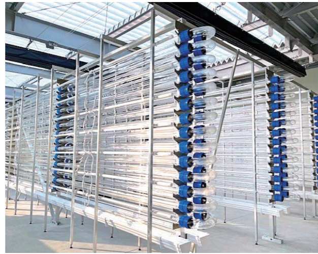
ベンチプラント内部
