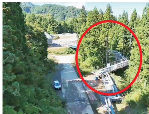
景観への負荷軽減と環境配慮とのバランスを考慮し、ブナなどの位置を1本1本測量して、極力伐採本数を減らすように設計し、樹林帯の中に配管を通した
