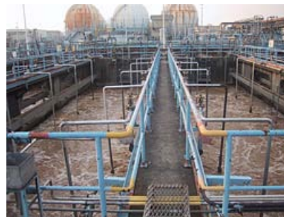
活性汚泥処理装置
