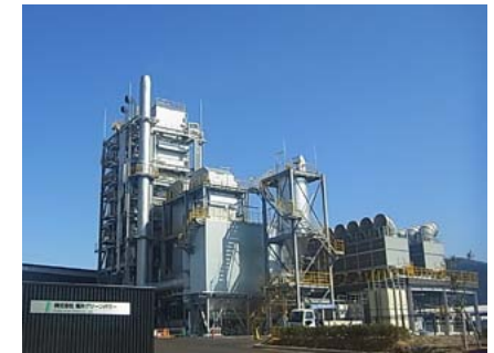
大野発電所全景
