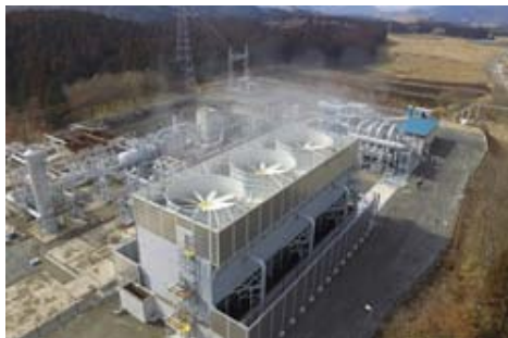
滝上バイナリー発電所
