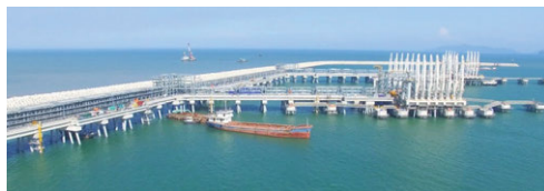
ニソン製油所・石油化学コンプレックスの湾岸エリアの建設
