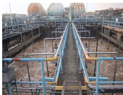
活性汚泥処理装置
